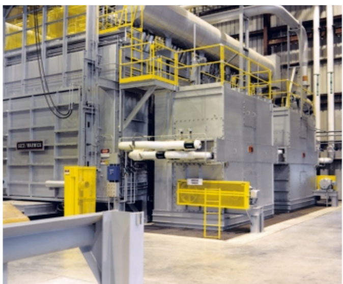
Система Vortex Flow установленная в печи
